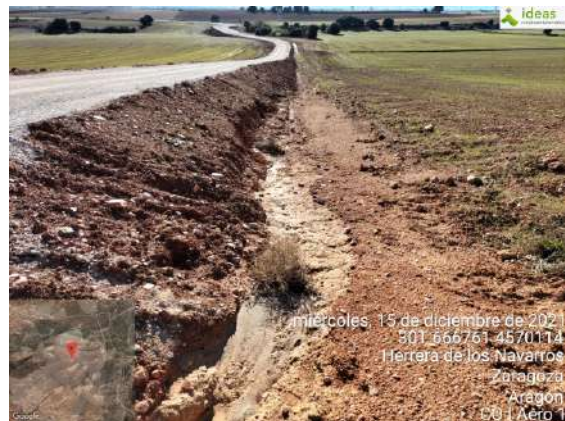
Fotografía 2. Procesos erosivos en la cuneta del vial del aerogenerador LCO1-01.
