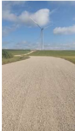
Fotografía 7. Estado de los caminos y cunetas entre los viales de acceso de LCO1-01 y LCO1-02.
