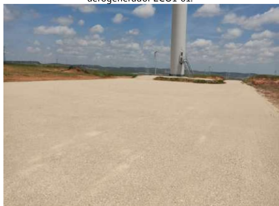
Fotografía 4. Estado de la plataforma del aerogenerador LCO1-04.
