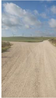
Fotografía 5. Estado de los caminos y cunetas en la división entre los viales de acceso de LCO1-01 y LCO1-02.
