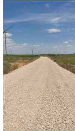
Fotografía 6. Estado de los caminos en el vial de acceso a LCO1-03.
